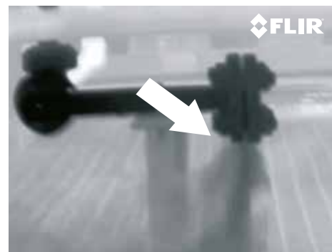
バルブのガス漏れ
