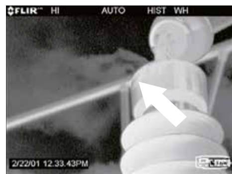
高圧機器用絶縁体からのSF6ガス漏れ
