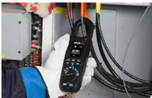
Überprüfung von Stromstärkemessungen
