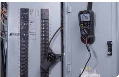
FLIR DM93マルチメーターに接続
