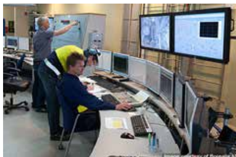
Im Kontrollraum werden alle Gasströme in der ganzen Anlage eng überwacht.
