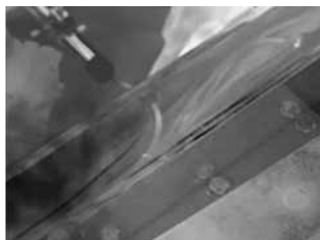
Noch eine ungewöhnliche Stelle für ein Leck. Durch eine Undichtigkeit in einer Verbindung strömt das Gas aus dem Dämmstoff aus.
