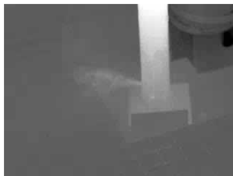
Lecks können an unerwarteten Stellen auftreten, wie z. B. in diesem Trägerrohr.
