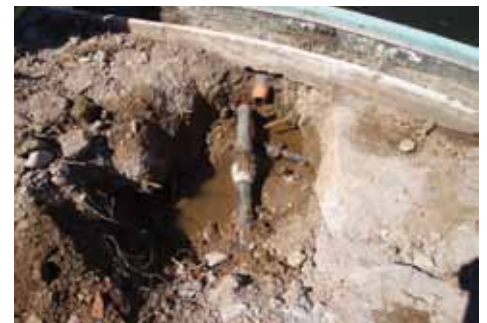
Gli addetti alle riparazioni hanno scoperchiato la pavimentazione dove sono state individuate le perdite, per esporre le tubazioni fessurate o rotte, confermando i risultati dell'indagine termografica.
