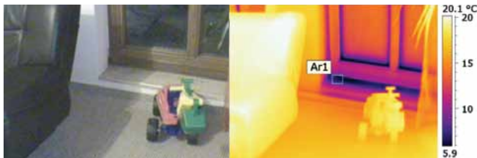
Questo test Blower Door mostra chiaramente la presenza di perdite d'aria dall'intelaiatura della finestra.
