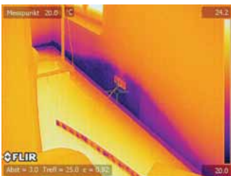
Questo danno causato dall'acqua evidenzia chiaramente il vantaggio della funzione Picture-in-Picture in quanto il cliente riesce a riconoscere facilmente la posizione dell'immagine termica, mentre sarebbe più difficile riuscirci con una normale immagine termica.
