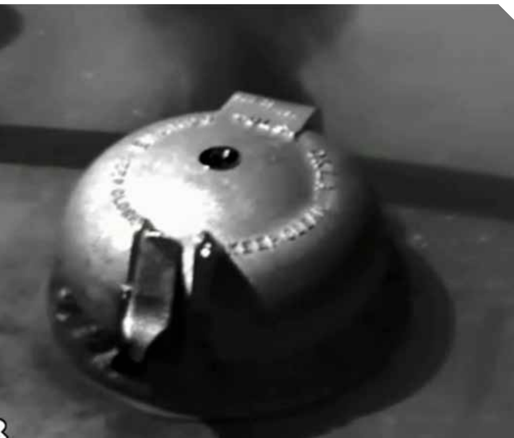
La termocamera per la rilevazione ottica di gas indica una perdita dal portello di sicurezza
