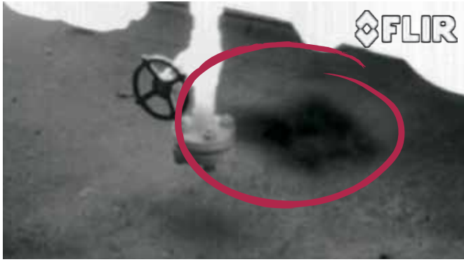
Fuga di gas rilevata in un impianto produttivo.
