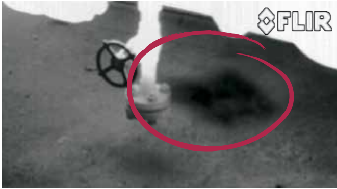
Détection d'une fuite de gaz sur le site de production.
