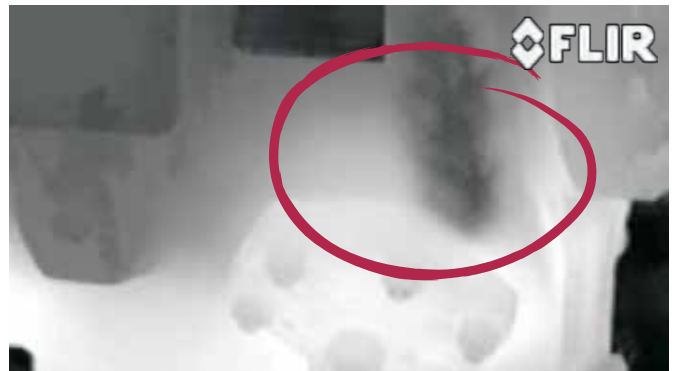
Détection d'une fuite de gaz.
