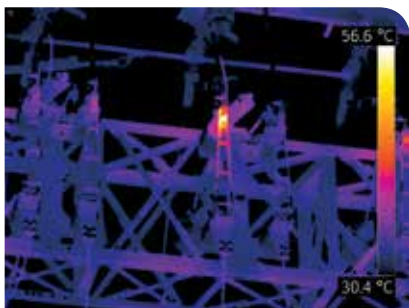
过热变电站断路器
