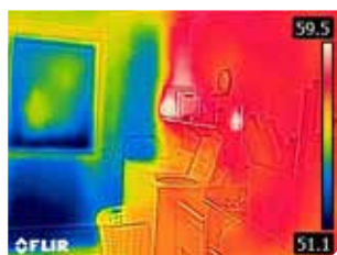
Parete esterna non isolata
