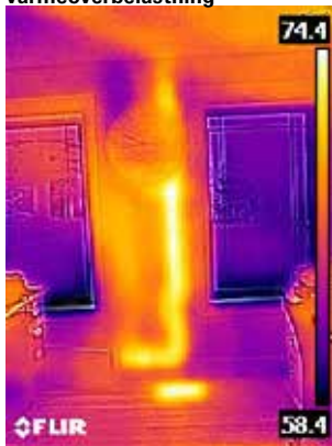
Varmeavløpsrør i vegg
