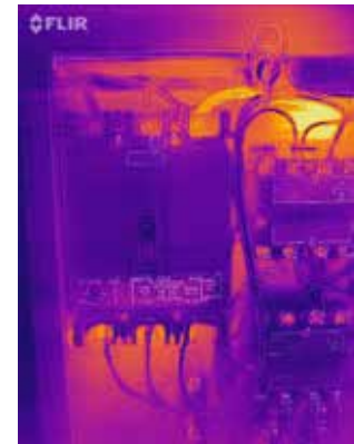
Identifique falhas elétricas
