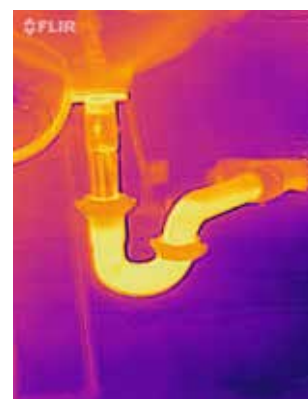
Verificare la presenza di infiltrazioni
