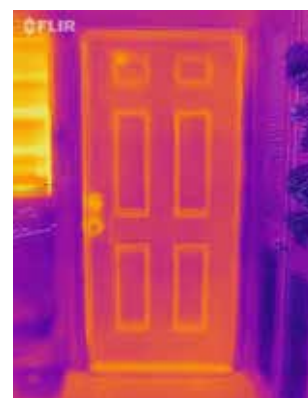
Individua segni di fughe d'aria e scarso isolamento
