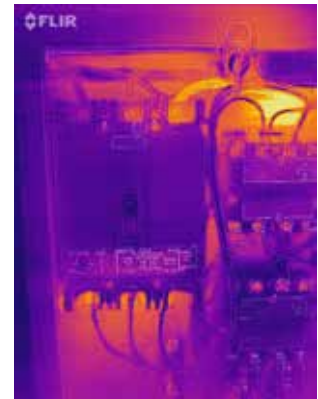
Erkennen Sie elektrischer Defekte
