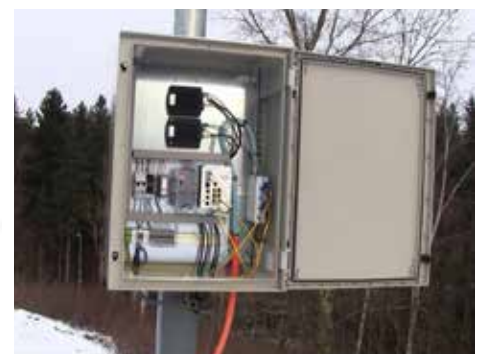
Die von den Wärmebildkameras gemachten Live-Bilder werden digitalisiert und mittels Glasfaserkabel in den Kontrollraum übertragen.
