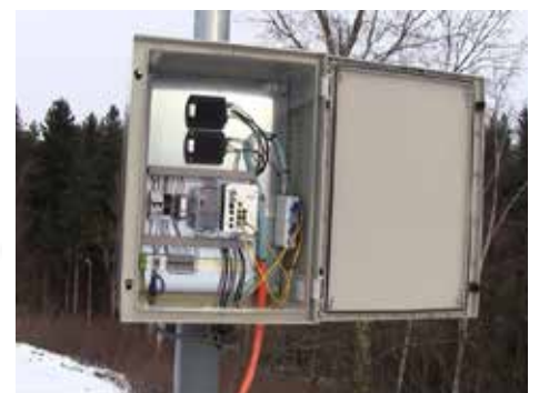
来自红外热像仪的现场画面经过编码，通过光纤电缆，被传输到控制站。
