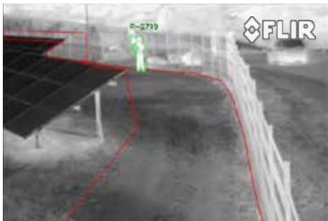
フェンスだけでは侵入者を防げない。フェンスは比較的簡単に乗り越えることができるが、サーマルカメラを使えば、侵入者が敷地内に入る前に検出できる。
