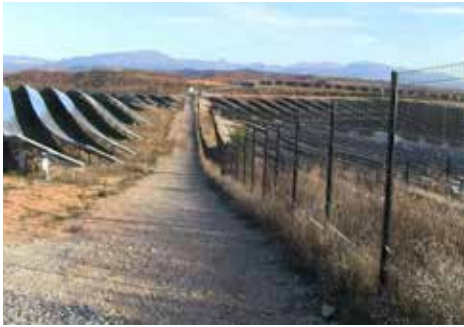
フェンスとサーマルカメラを併用して外周全体で侵入者を防いでいる。
