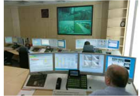
BASF控制室是安防网络的中心，所有CCTV摄像机和红外热像仪的录像均在此进行分析。
