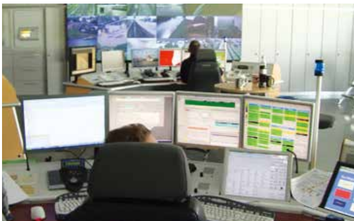
Krüger氏のチームはこの制御室でCCTVカメラとフリーシステムズの赤外線カメラをすべて監視している
