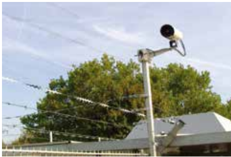
赤外線カメラFLIR SR 324は1台でフェンス全体を監視できる
