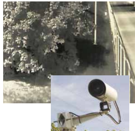
この場所は風に揺れる木の枝が頻繁にアラームを誤作動させるため、Krüger氏はCCTVカメラを赤外線カメラと交換した。赤外線カメラを設置してから誤動作は一度も起こっていない。
