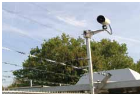
La caméra thermique FLIR SR-324 couvre la totalité de cette barrière.
