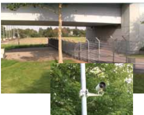
Diese Wärmebildkameras von FLIR überwachen einen der durch Hochwasser bedrohten Bereiche. Sie kommen ohne jegliche Beleuchtung aus und können dank ihrer großen Reichweite den gesamten Bereich aus sicherer Entfernung überwachen.
