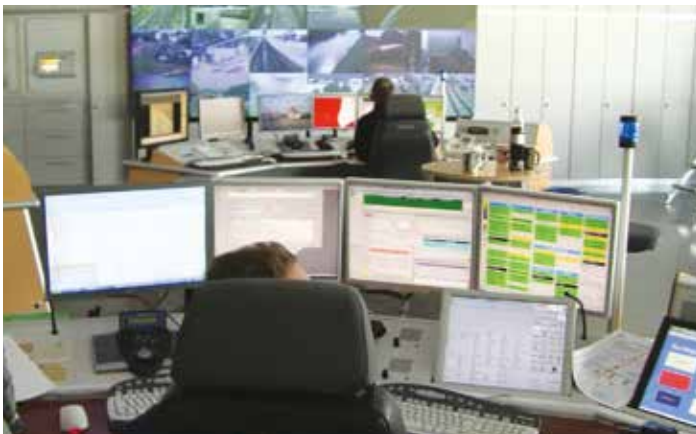
在这个监控室内，Krüger和他的团队监控所有的闭路电视摄像机和FLIR红外热像仪。
