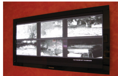
Тепловые изображения, полученные с помощью шести тепловизионных камер FLIR SR-313, можно вывести на любой из экранов внутри здания
