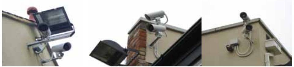
Diese sechs FLIR SR-313 Wärmebildkameras decken die Rückseite des Geländes ab.
