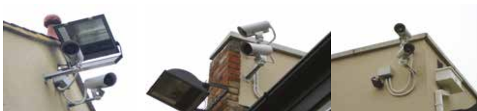
这6台FLIR SR-313红外热像仪覆盖住宅后方范围。
