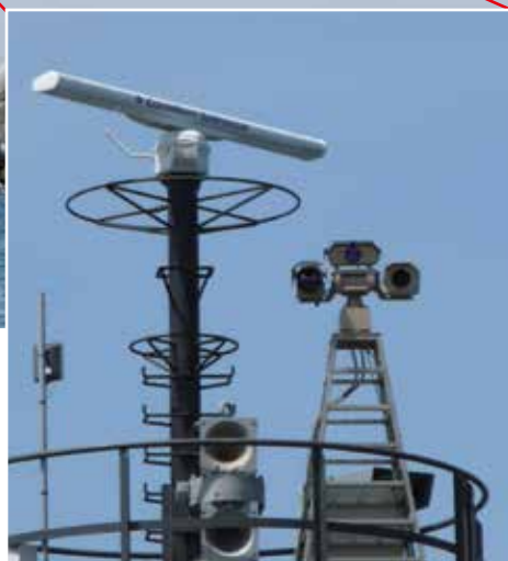
ラヴェンナ港のHRC-S MSは全長3キロの埠頭の端にある高さ14メートルの柱に取り付けられている
