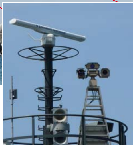
Die HRC-S MS wurde im Hafen von Ravenna auf einem 14 Meter hohen Mast am Ende eines 3 Kilometer langen Piers installiert.
