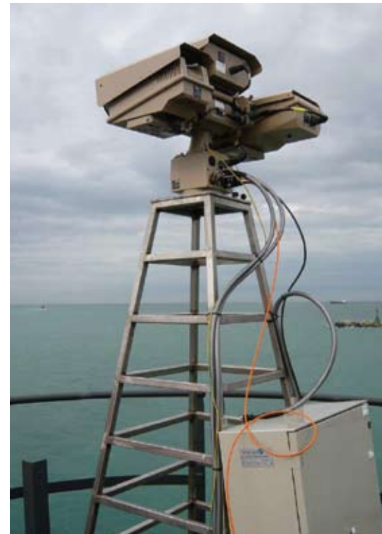
Die HRC-S MS überwacht den Eingang des Hafens von Ravenna.
