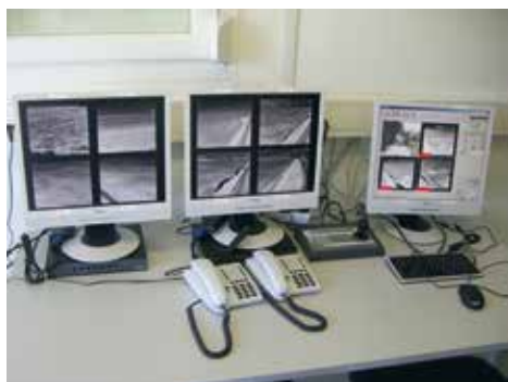
コントロールルームの一部
