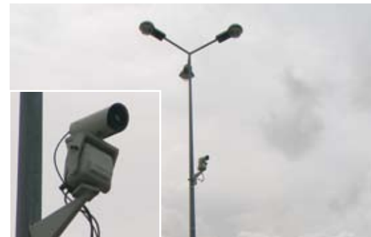
Une des caméras FLIR Systems SR-50 installée sur le Port de Calais
